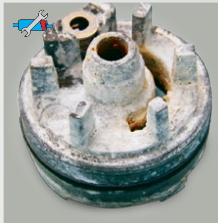
Fig. 50: Cuscinetto esterno coperto di calcare di una pompa di alimentazione carburante
